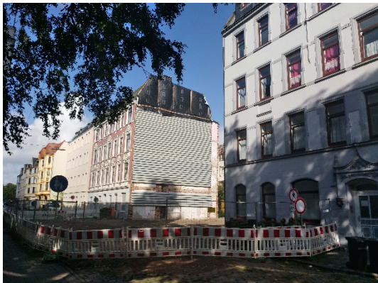
Abb. 05: Baulücke Heinrichstraße 34, Blick auf die statische Absicherung der Trennwand von Haus Nr. 36 (Quelle: FORUM Huebner, Karsten & Partner)
