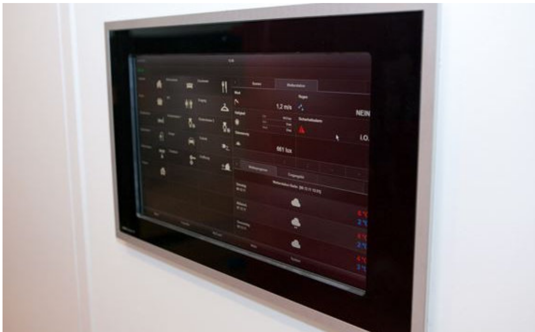
Touchpanel zur Steuerung der Haustechnik
