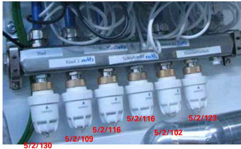
Bild 13: Heizkreisverteiler EG. Aufnahmedatum 15.01.2013.
