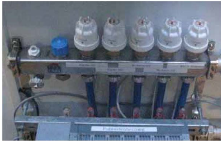
Bild 11: Heizkreisverteiler EG. Aufnahme datum 15.01.2013
