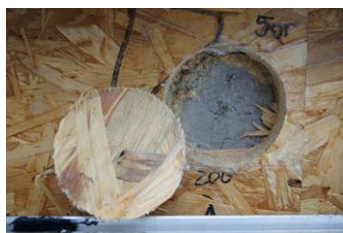
BILD 9-23 ZUSTAND DER SCHICHTGRENZE GEFACHDÄMMUNG / AUßENSEITIGE GEFACHBEPLANKUNG AN GEFACH 5 OBEN RECHTS AM 24.01.2013 UND ABMESSUNGEN DER ENTNAHMEPROBEN AUS DER GEFACHBEPLANKUNG
