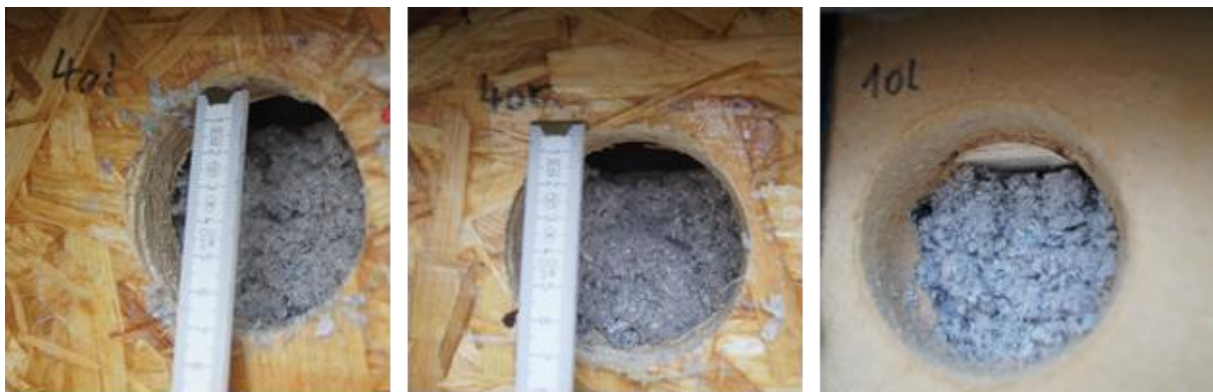
BILD 9-27 NACHSACKUNG IN DER DÄMMUNG VON GEFACH 1 UND GEFACH 4, AUFGENOMMEN AM 03.04.2015
