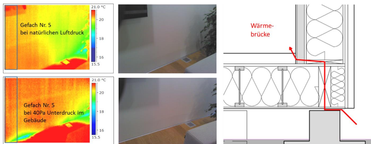
BILD 7-2 IR-THERMOGRAMME UND ZUGEORDNETE FOTOS VON DER SSW-AUßENWAND IM ERDGESCHOSS BEI NATÜRLICHEM LUFTDRUCK IM GEBÄUDE UND BEI 40 PA UNTERDRUCK IM GEBÄUDE MIT KENNZEICHNUNG VON GEFACH 5 MIT MESSFÜHLERN
