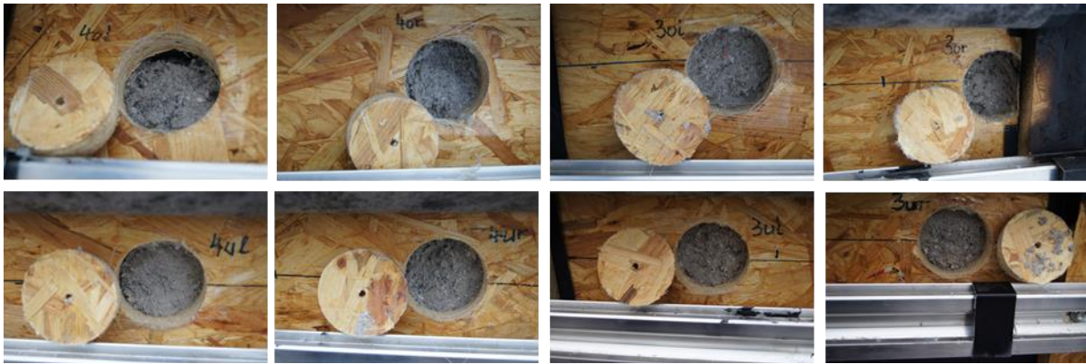
BILD 9-22 ZUSTAND DER SCHICHTGRENZE GEFACHDÄMMUNG / AUßENSEITIGE GEFACHBEPLANKUNG AN GEFACH 3 UND 4 AM 24.01.2013
