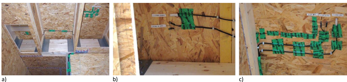
BILD 6-9 FOTOS ZUR BAUWEISE UND ANORDNUNG DER MESSFÜHLER IN DER DACHPLATTE A) ÜBERSICHT, B) EINSCHLAGELEKTRODEN UND ZUGEHÖRIGE TEMPERATURFÜHLER ZUR TEMPERATURKOMPENSATION DER MATERIALFEUCHTE IN DER AUßENSEITIGEN OSB-PLATTE IM TRAUFNAHEN BEREICH OHNE PV-MODULE B) DTO., ZUDEM MIT OBERFLÄCHENTEMPERATURFÜHLER ZUR TEMPERATURKOMPENSATION DER MATERIALFEUCHTE – ALLE MESSFÜHLER IM BEREICH VON PV-MODULEN
