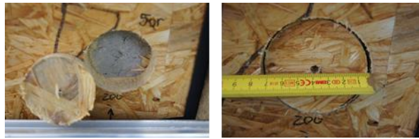
BILD 9-18 ZUSTAND DER SCHICHTGRENZE GEFACHDÄMMUNG / AUßENSEITIGE GEFACHBEPLANKUNG AN GEFACH 5 OBEN RECHTS AM 27.04.2012 UND ABMESSUNGEN DER ENTNAHMEPROBEN AUS DER GEFACHBEPLANKUNG
