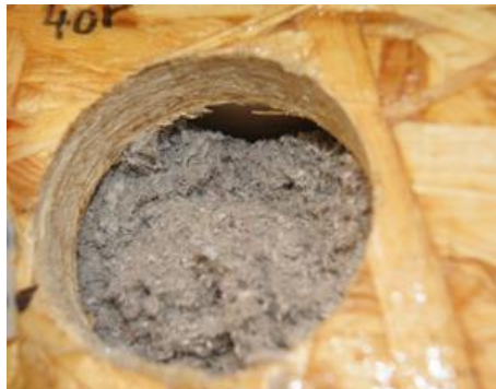
BILD 9-26 NACHSACKUNG DER DÄMMUNG UM CA. 10MM IN GEFACH 4, AUFGENOMMEN AM 18.04.2013
