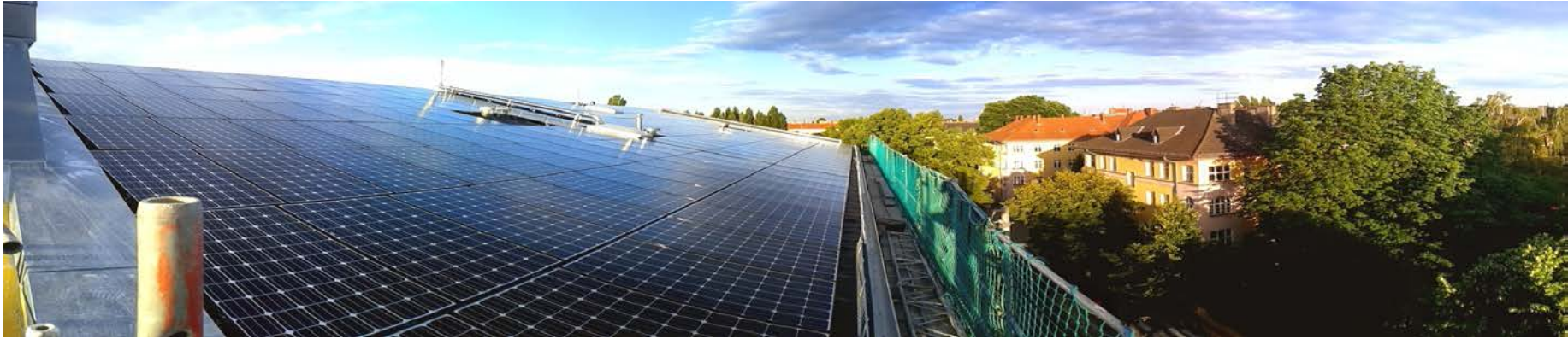
Photovoltaik-Anlage auf dem Dach des LaVidaVerde – Gebäudes [Quelle: LaVidaVerde]
