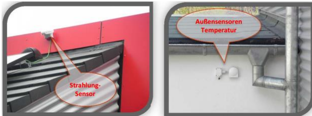
Abbildung 6: Sensoren im Außenbereich
