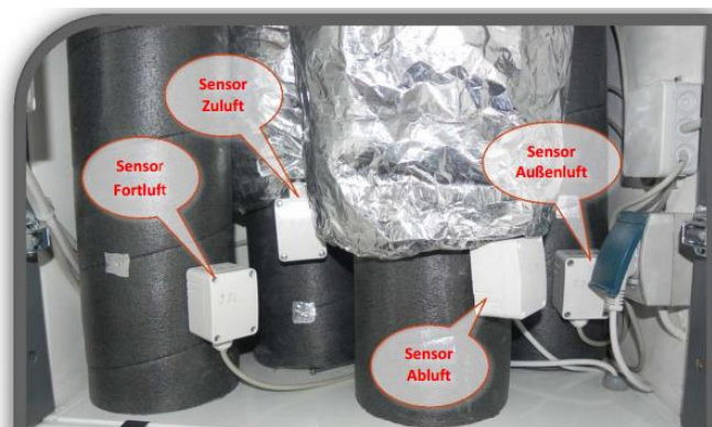
Abbildung 5: Temperatursensoren an einer der beiden Lüftungsanlagen
