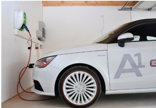
Ladestelle in der Garage
