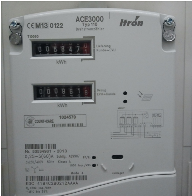
Messgerät zur Erfassung der Strommengen
