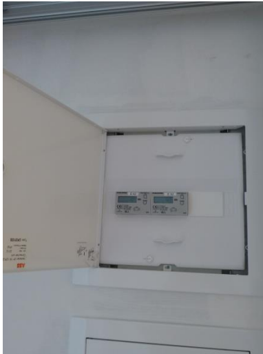
Bild 23: Stromzähler für Herd und Küche in der Wohnung
