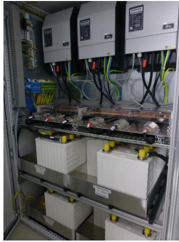
Bild 19: Lithium-Ionen-Batterien des elektrischen Energiespeichers sowie Batteriewechselrichter
