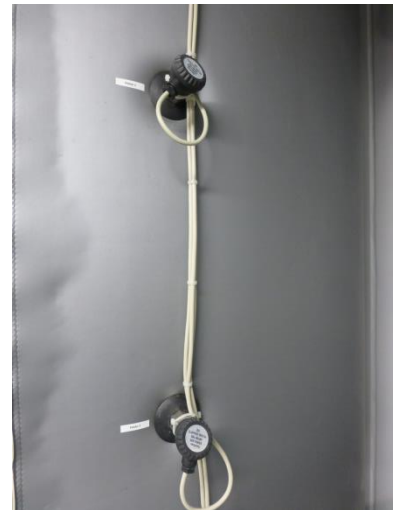
Bild 28: Temperatursensoren am Pufferspeicher
