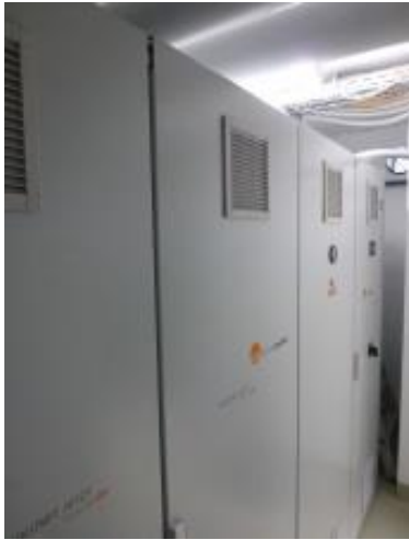
Bild 18: Außenansicht des elektrischen Energiespeichers
