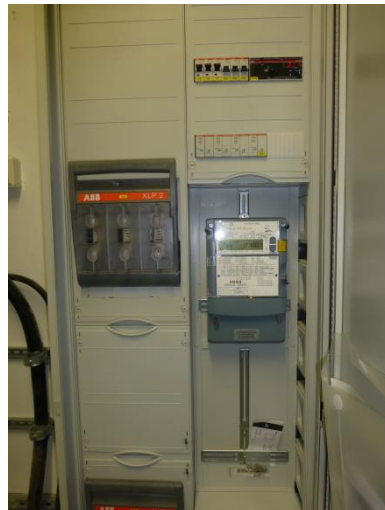
Bild 27: Übergabezähler am Hausanschluss
