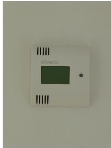
Bild 24: Raumtemperatur und Raumluftfeuchtesensor in einem Wohnraum
