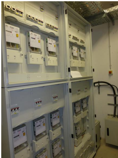
Bild 26: Haushaltsstromzähler im Elektroraum mit Impulsschnittstelle
