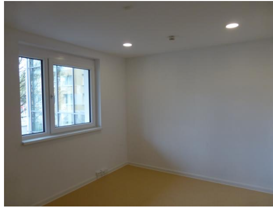
Bild 15: Energieeffiziente LED-Beleuchtung in den Räumen
