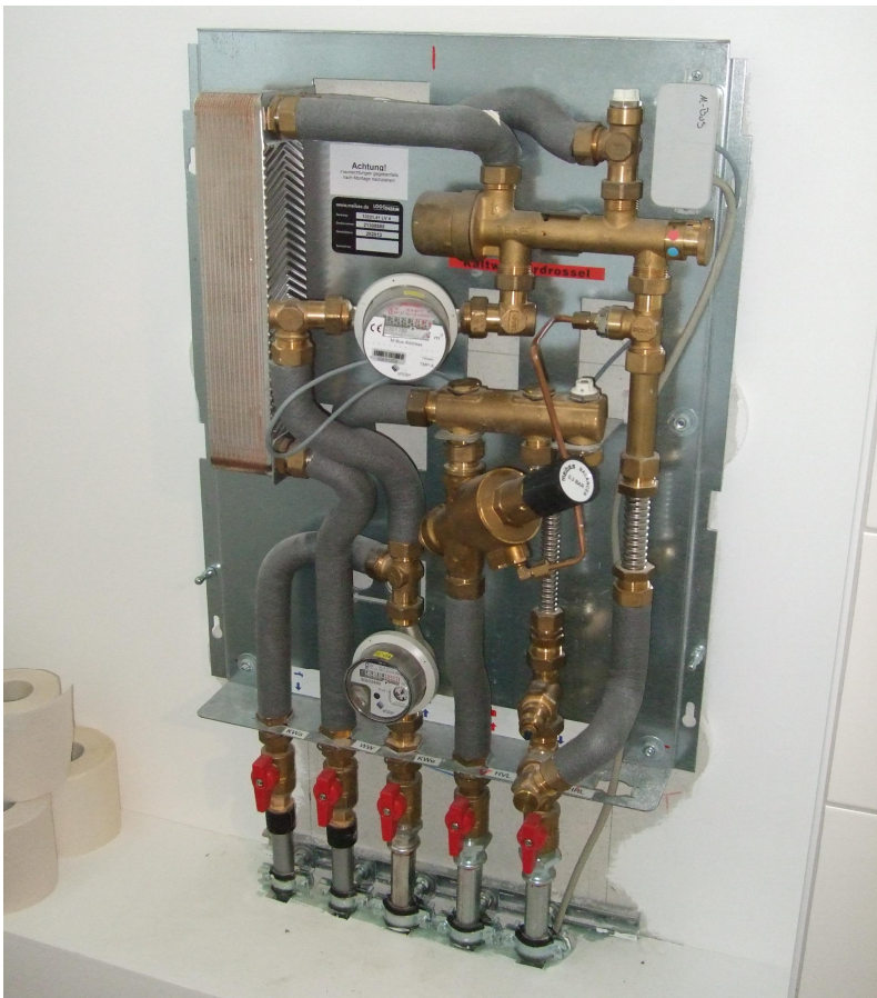
Abb. 16 Frischwasserstation im Bad einer Wohneinheit mit Durchflussmengen-zähler, Quelle: ina Planungsgesellschaft mbH
