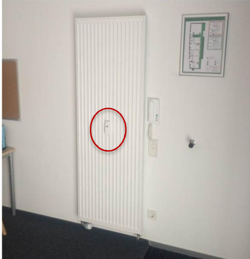
Abb. 15 exemplarische Darstellung des Heizkostenverteilers an einem Heizkörper einer Wohneinheit; Quelle: LBIH
