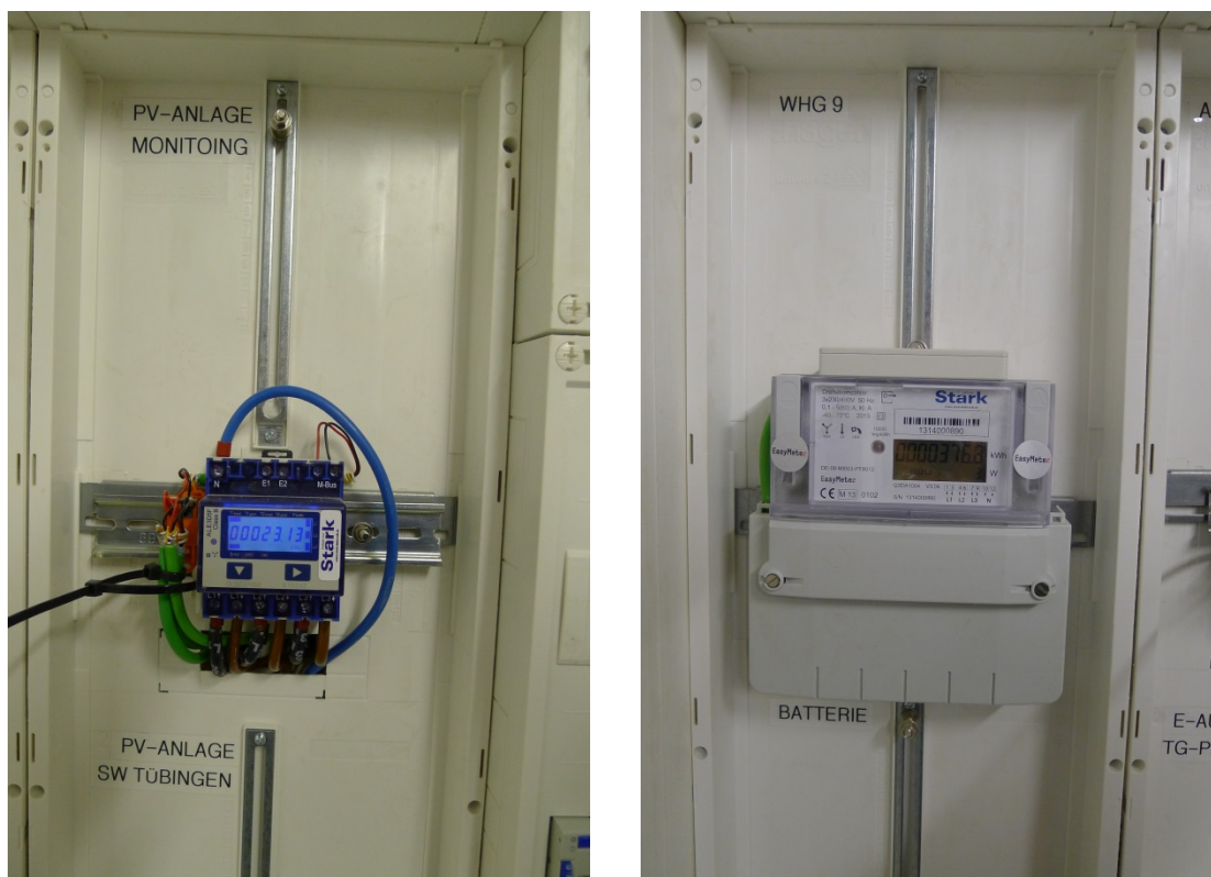
Abbildung 27: (a) Energiezähler für PV-Ertrag / (b) Wohnungshauptzähler, hier WE9 [Erhart]..
