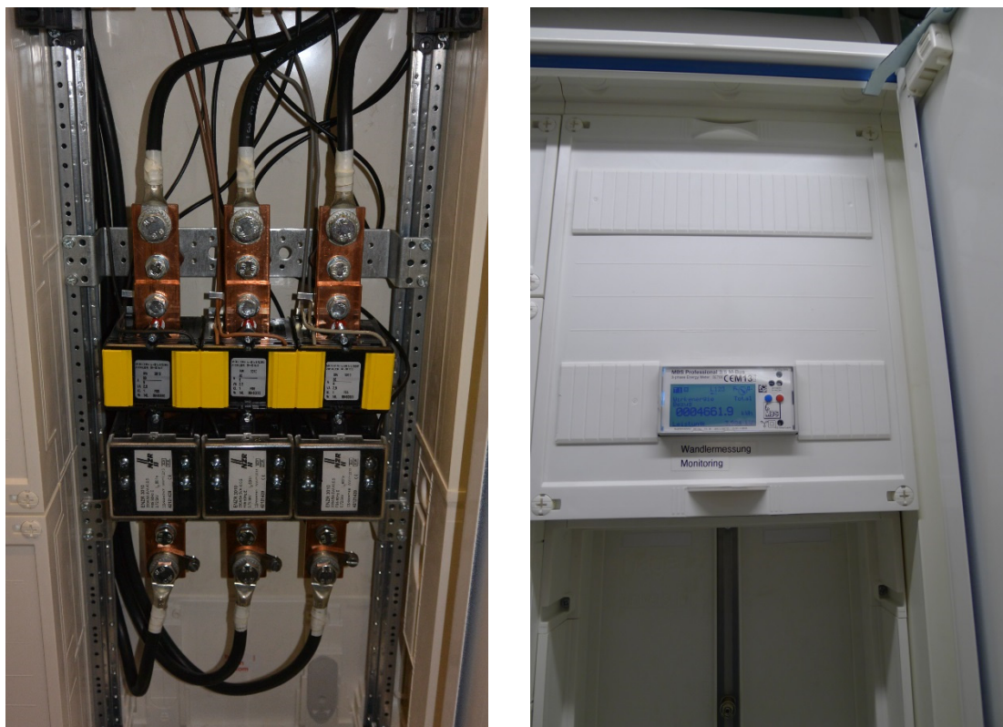
Abbildung 22: Hauptwandlernerfassung am Übergabepunkt ((a)Wandler/ (b)Zähler) [Erhart].
