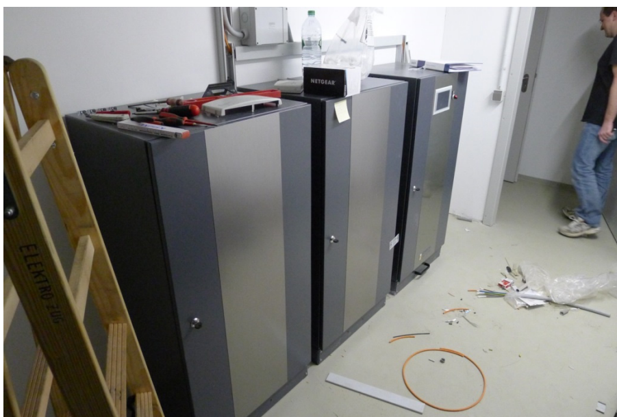
Abbildung 15: Elektrisches Speichersystem Sonnenbatterie 40 kWh brutto [Erhart].
