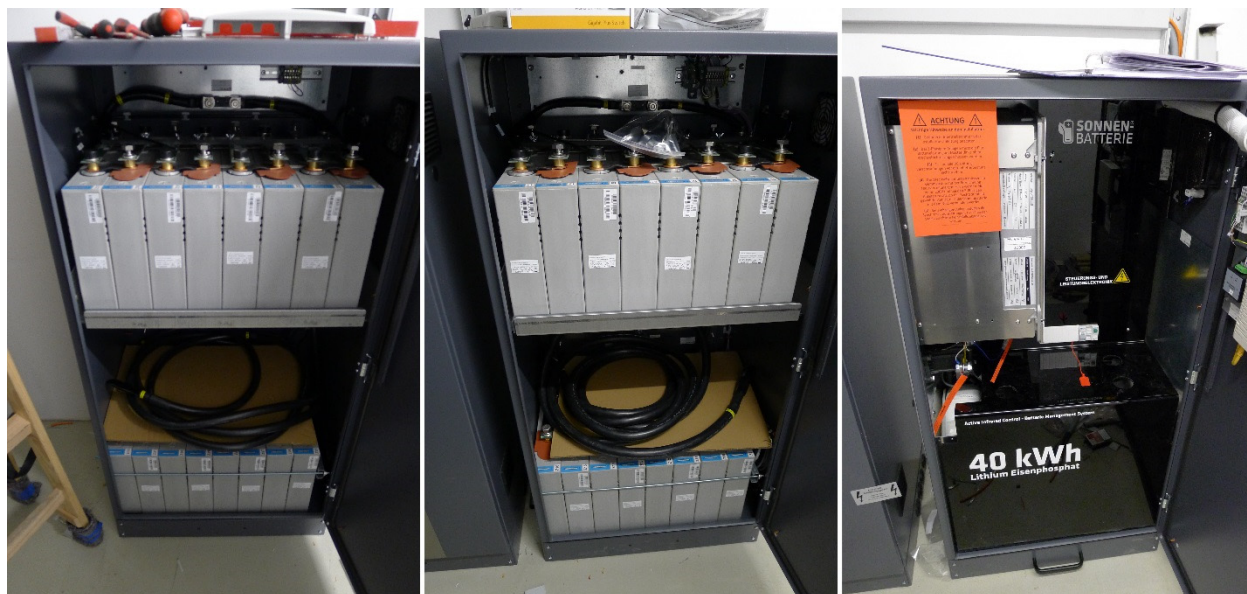
Abbildung 16: Elektrisches Speichersystem, Batteriegehäuse (links (a) und Mitte(b)), Wechselrichter mit Steuerungseinheit (rechts (c)) [Erhart].
