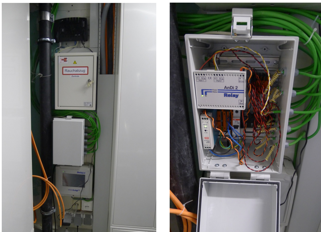
Abbildung 25: (a) Anordnung von M-Bus Klemmenkasten und M-Busmaster / (b) Innenansicht Klemmenkasten mit A/D-Wandler [Erhart].
