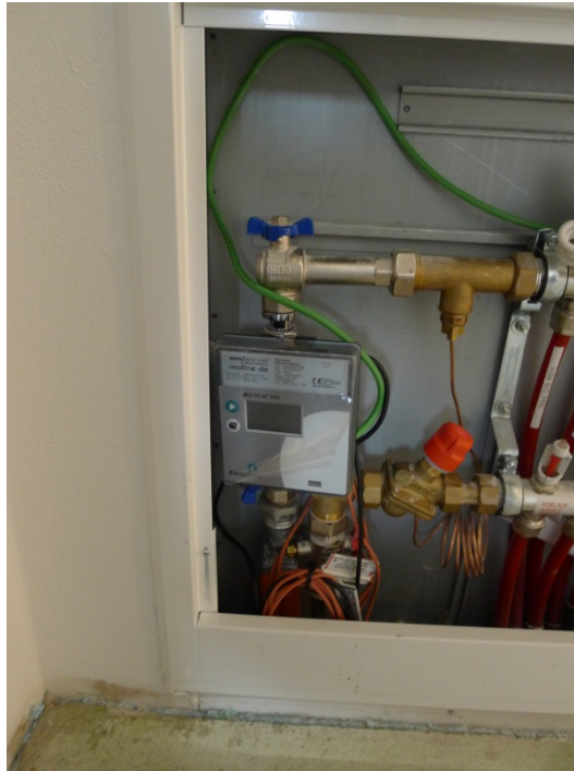
Abbildung 26: Wärmemengenzähler, Einbausituation im Heizungsverteiler der Fußbodenheizung [Erhart].
