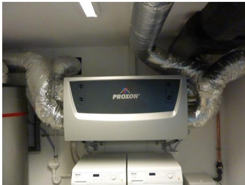
Bild 8: Zentrallüftungsgerät mit integrierter Luft/Luft-Wärmepumpe im Effizienzhaus Plus Generation 5.0 WeberHaus.
