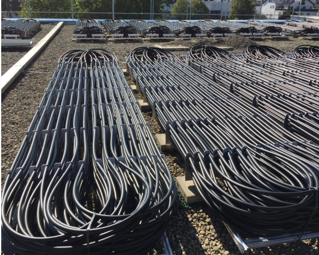
Rohrbündelabsorber auf dem Flachdach
