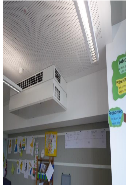
Einzellüftungsgerät mit Zu- und Abluftkanal
