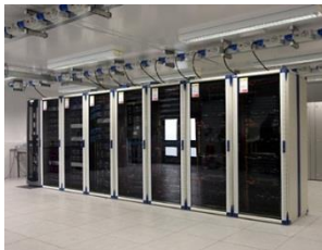
Server Kühlung ca. 25°C
