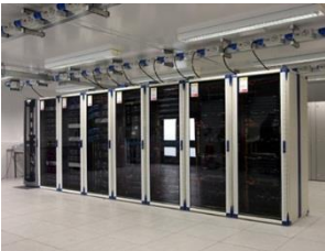
Server Kühlung ca. 25°C
