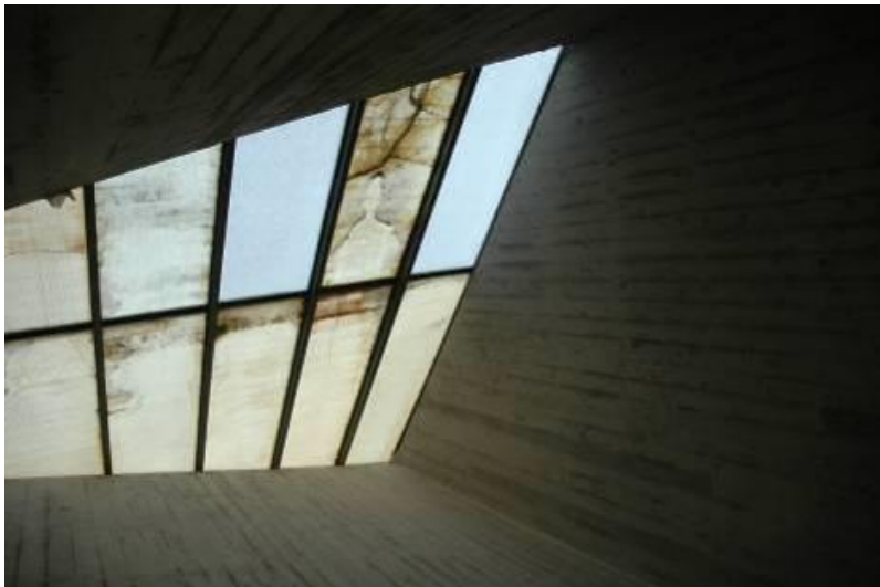
Verbrauchte Dachverglasung, z.T. blind – kein Sicherheitsglas
