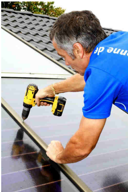
Quelle: BSW Solar
